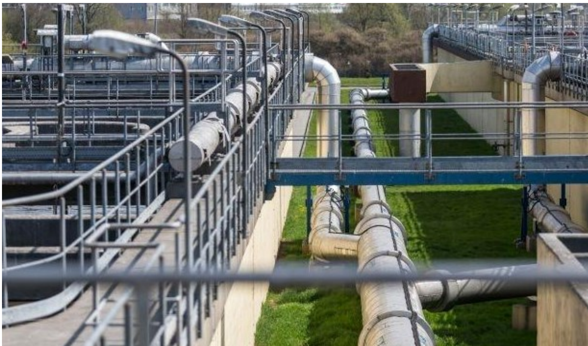
Rys. 2. Reaktory OŚ Płaszów z kolektywami doprowadzającymi powietrze [6]
